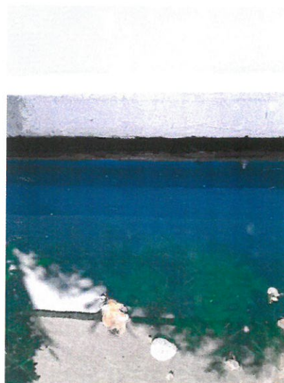
L'eau ne s'évacue pas
