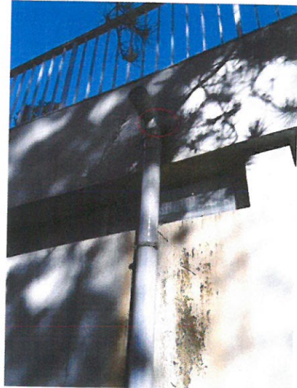
Ressortie d'eau en façade
