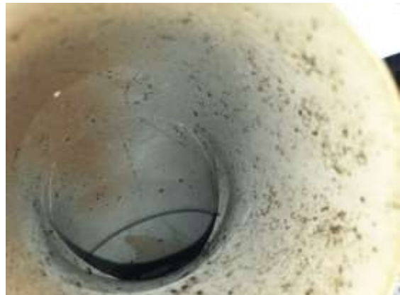
Condensation dans évent
