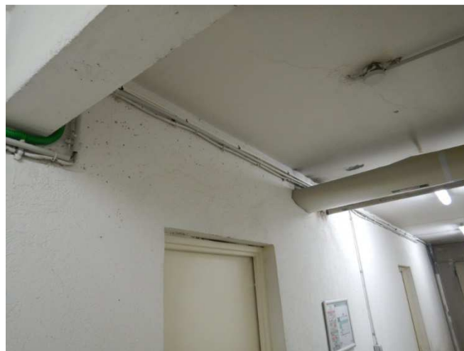
Plancher bas sur caves non isolé
