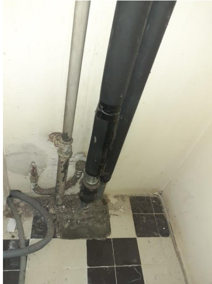
Réseaux ECS et bouclage calorifugés
