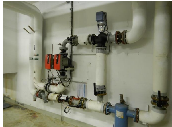
Circulateur réseau primaire et vanne trois voies
