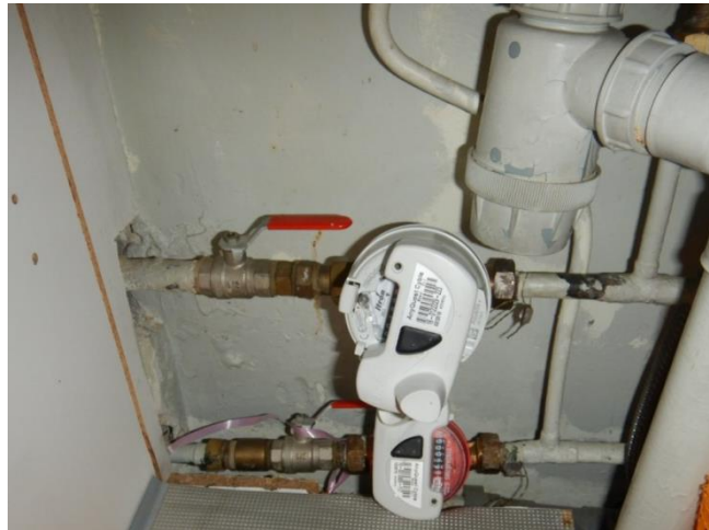
Compteurs dans un logement
