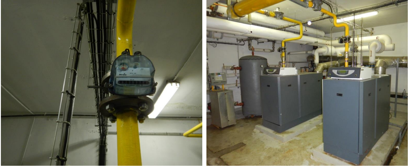
Compteur gaz pour chaque chaudière
