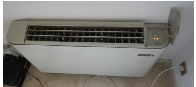
Ventilo convecteur (situé dans les salons)
