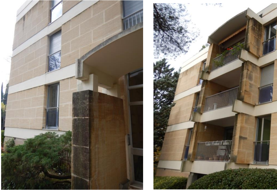
Traces d'humidité sur l'immeuble du Grand Pin
