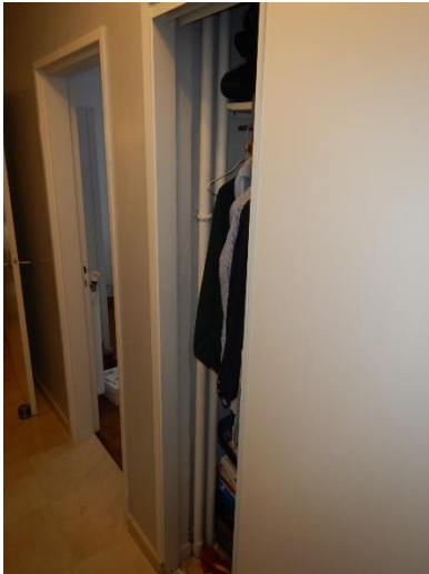
colonne montante radiateurs
