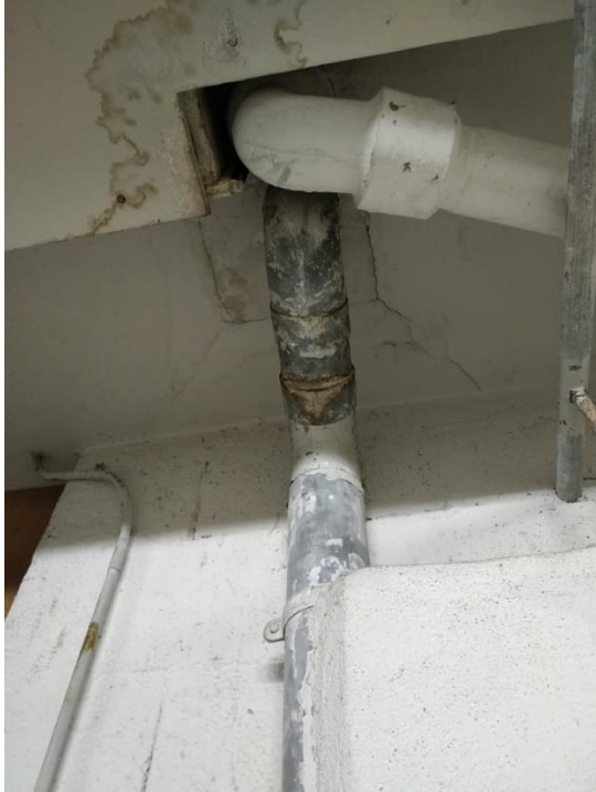
Raccord gouttière sur chute EU
